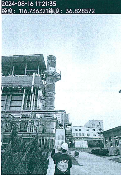
4#燃气轮机组排气筒 (DA019)
