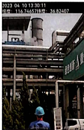
1#燃气轮机组排气筒 (DA001)
