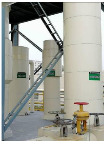
冷凝水换热器
