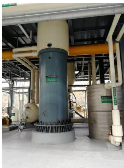
二效加热器、冷冻机循环水箱
